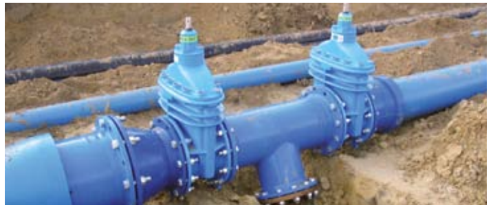
Canalisation incendie avec vannes
